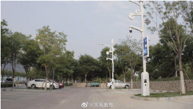
中新天津生态城甘露溪公园里的光伏智慧路灯
